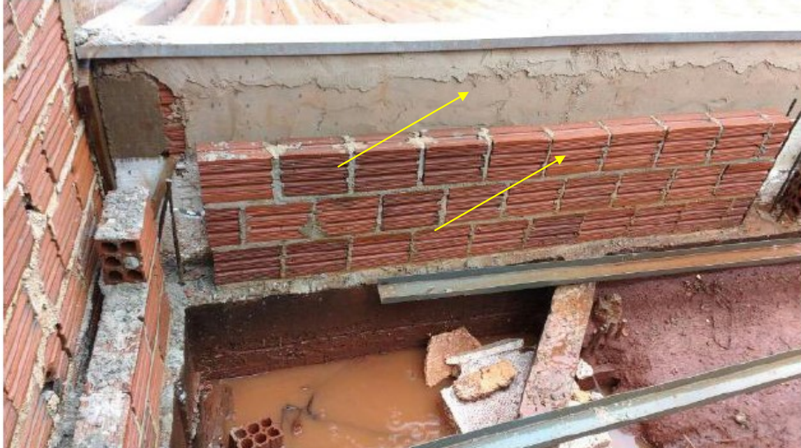
Imagem 18 – Ausência de Drenagem acumulo de água
