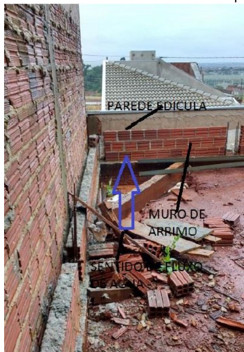
Imagem 19 – Ausência de Drenagem, percolação de água imóvel do requerente
