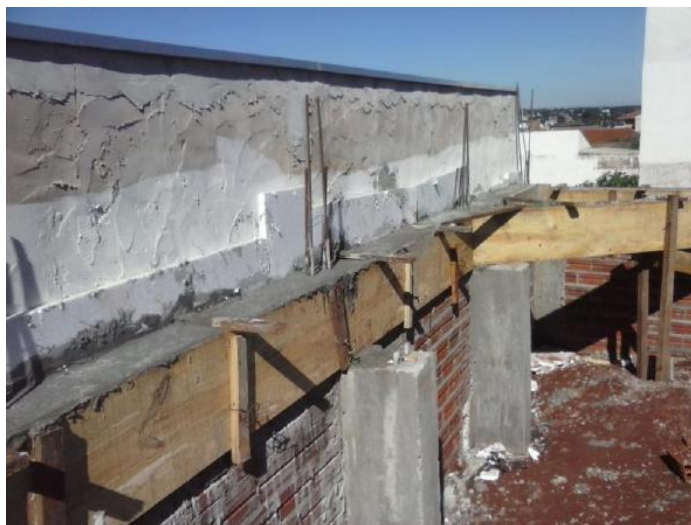
Imagem 15– Muro de arrimo junta sem impermeabilização e muro sem impermeabilização
