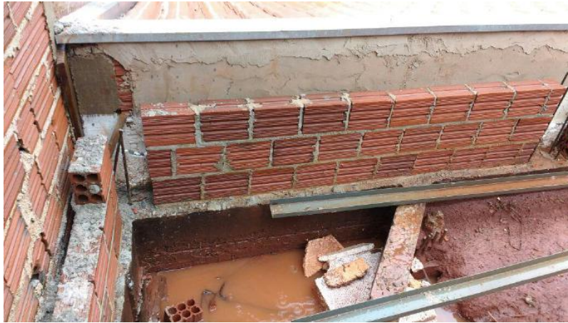
Imagem 18 – Ausência de Drenagem acumulo de água
