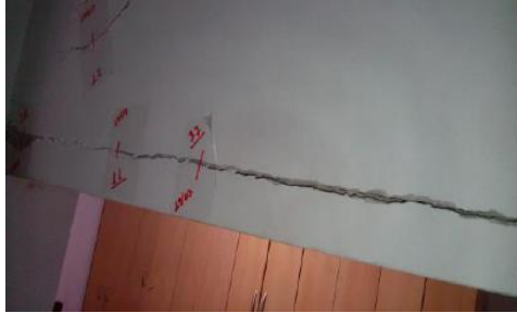
Imagem 41 – Trincas na EStrutura
