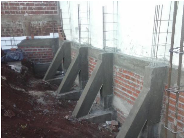
Imagem 14– Muro de arrimo junta sem impermeabilização e muro sem impermeabilização
