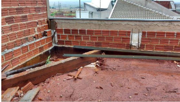
Imagem 20 – Ausência de Drenagem, percolação de água imóvel do requerente
