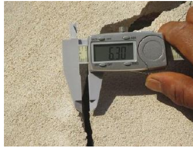
Imagem 24 – trincas na estrutura 6,3 mm
