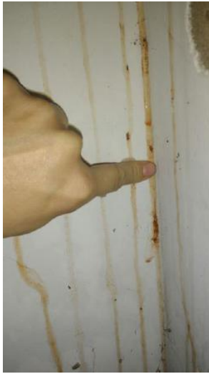
Imagem 31 – Percolação de água - parede
