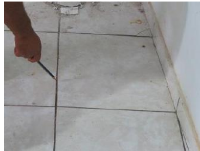
Imagem 34 – Brecha em Piso – Movimentação da Estrutura
