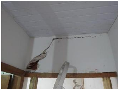
Imagem 33– Brecha nas paredes
