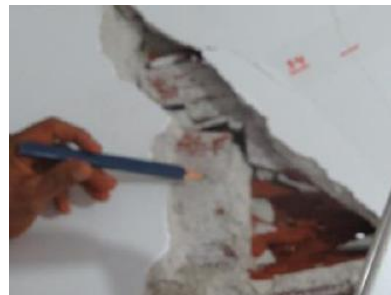
Imagem 36 –Brecha na Parede de divisa
