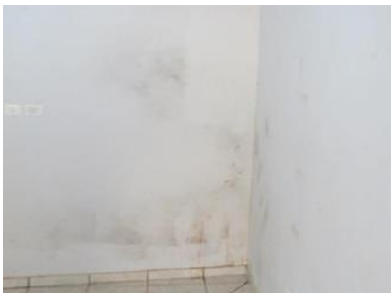
Imagem 29 – Umidade nas Paredes (requerente)
