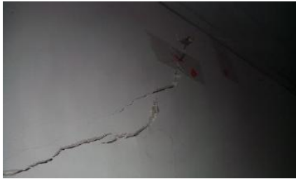
Imagem 42 – Trincas na Parde
