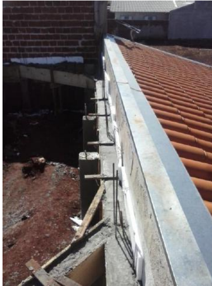
Imagem 16 - Muro de arrimo junta sem impermeabilização e muro sem impermeabilização
