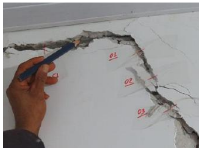
Imagem 37 – Brecha em Parede de Apoio
