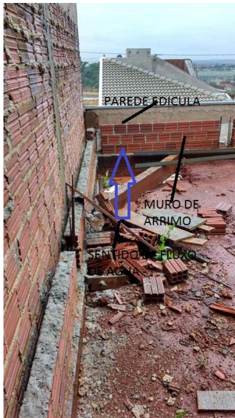
Imagem 19 – Ausência de Drenagem, percolação de agua imóvel do requerente
