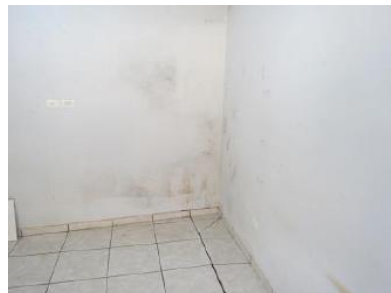
Imagem 30 – Umidade nas Paredes (requerente)
