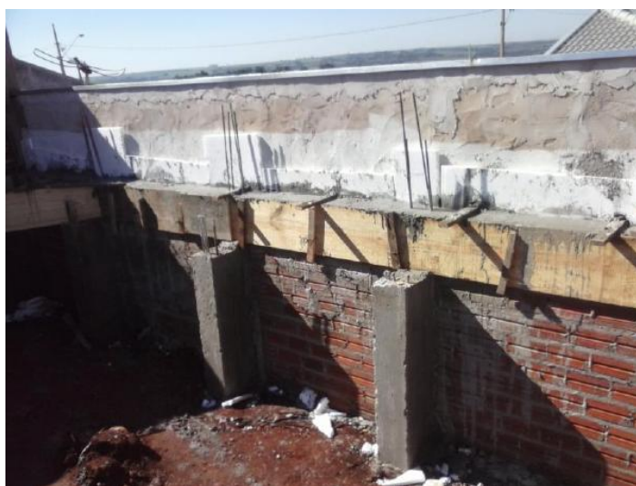
Imagem 13 – Muro de arrimo junta sem impermeabilização
