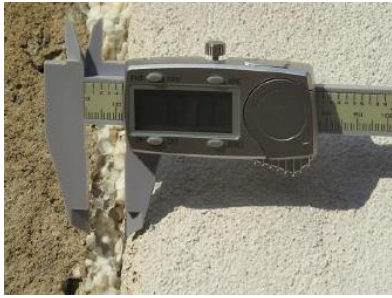
Imagem 23 – Medição de junta de dilatação 12,1 mm
