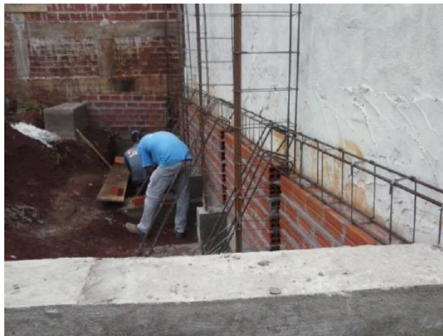
Imagem 10 – Muro de arrimo junto a estrutura vizinha sem impermeabilização
