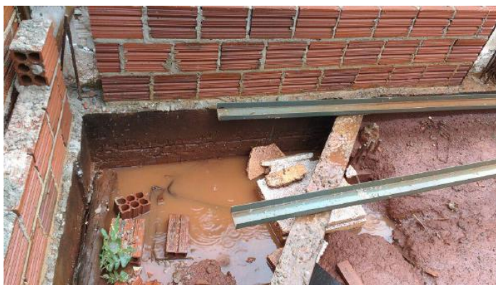
Imagem 17 – Ausência de Drenagem acumulo de água
