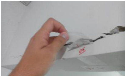
Imagem 44 – Trincas na Parede
