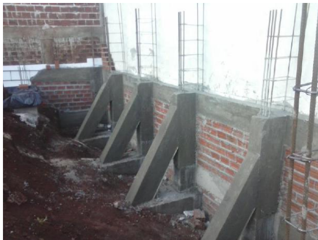
Imagem 11 – Muro de arrimo junto a estrutura vizinha sem impermeabilização
