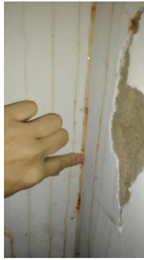
Imagem 32 – Percolação de água pela Parede
