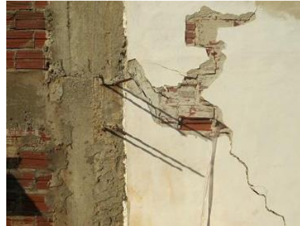
Imagem 22 trincas na estrutura do requerente
